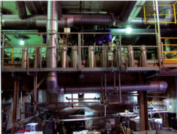
Der Ditzinger Hersteller von Parkettsiegeln und -ölen arbeitet mit großen Mengen. Im größten Ansatzbehälter können 20 t angesetzt werden.
